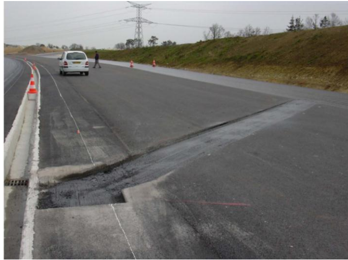
Figure 4 : Epi drainant sur couche de liaison (Source Département Laboratoire de Saint Briec).
