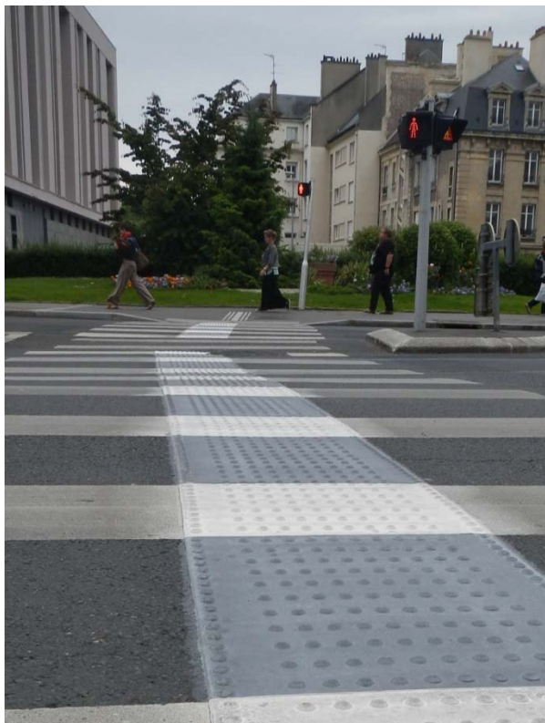
Prototype de guidage en traversée piétonne
