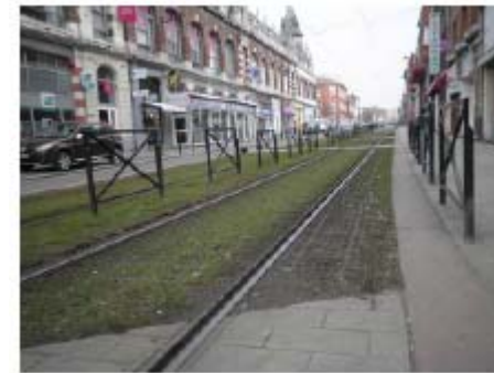
plate-forme gazonnée dégradée
