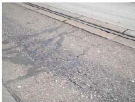
Orniérage et fissurations
