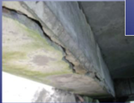
Les conséquences de la corrosion des aciers sur le béton
