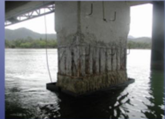
La corrosion des armatures
