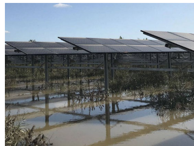
PV flottant (bassins)
