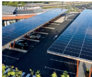
Ombrières aires d'autoroute
