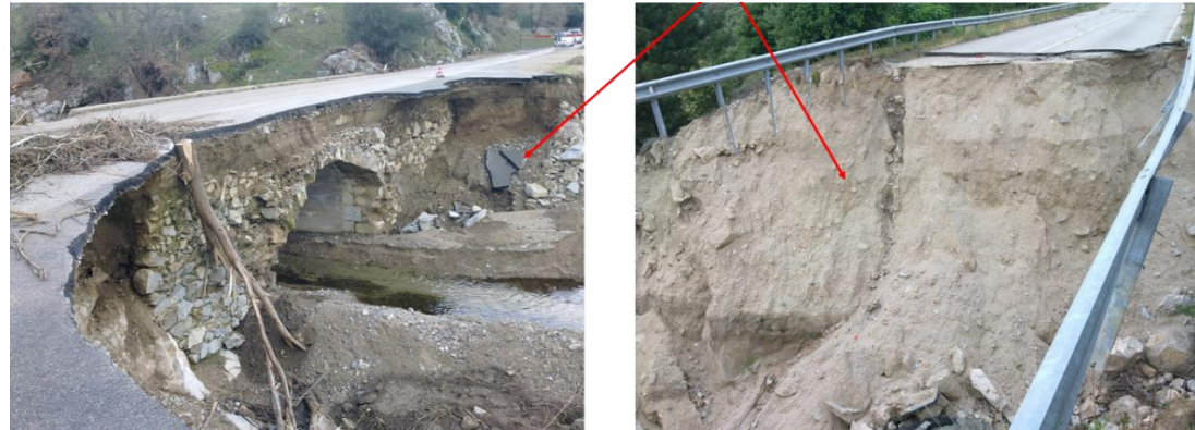
Remblai routier lessivé lors d'une inondation
