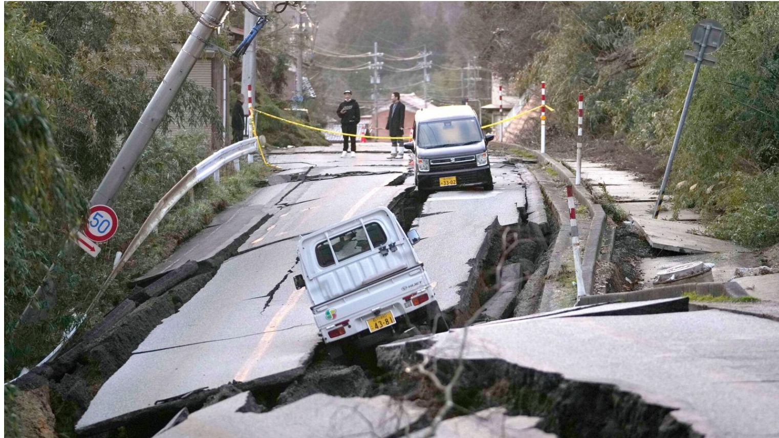
Effets d'un séisme sur une route
