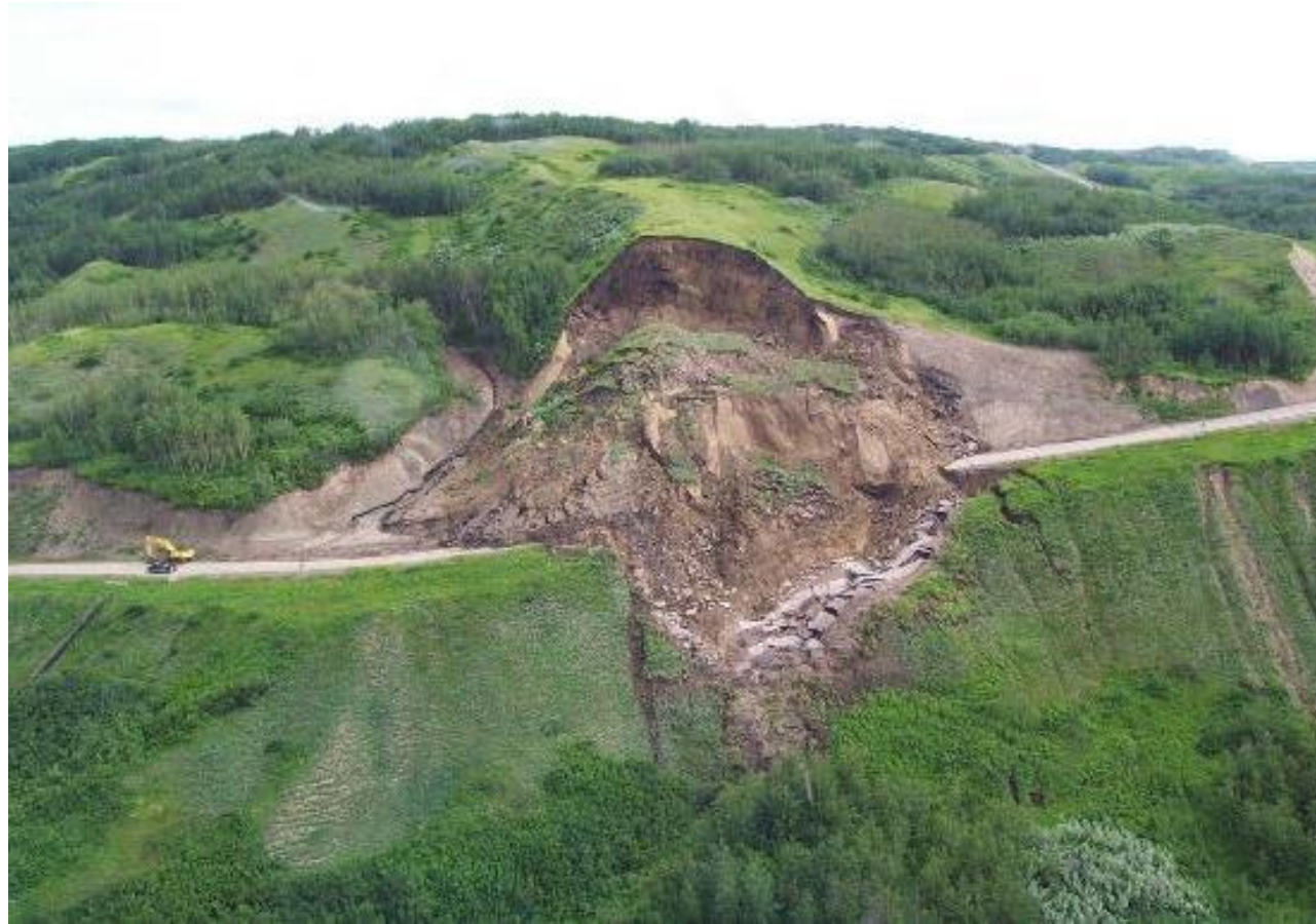
Grand glissement de talus
