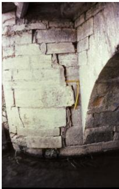
Photo n° 38 : fracture et déversement d'un avant-bec chargé par un élargissement mal conçu (crédit photo LRPC)
