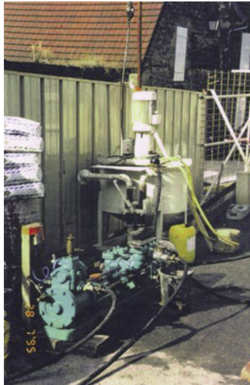
Photo n° 23 : centrale d'injection (crédit photo A. Bouineau)
