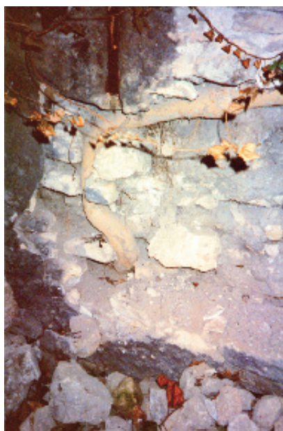
Photo n° 18 : d'autres actions pernicieuses peuvent s'exercer sur un mur de soutènement (crédit photo D. Poinneau)
