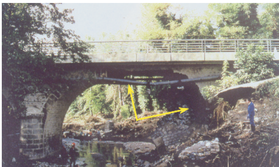
Photo n° 7 : conséquences sur une voûte d'affouillements pendant une crue (crédit photo DDE 84)
