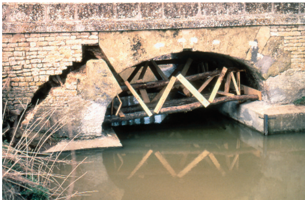
Photo n° 11 : l'étalement inadapte mis en place n'a pas empêché l'effondrement de la culée (crédit photo LRPC)
