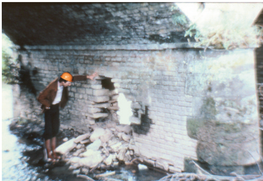
Photo n° 9 : mauvaise qualité du remplissage intérieur d'une pile du pont de Luze (crédit photo DDE 70)
