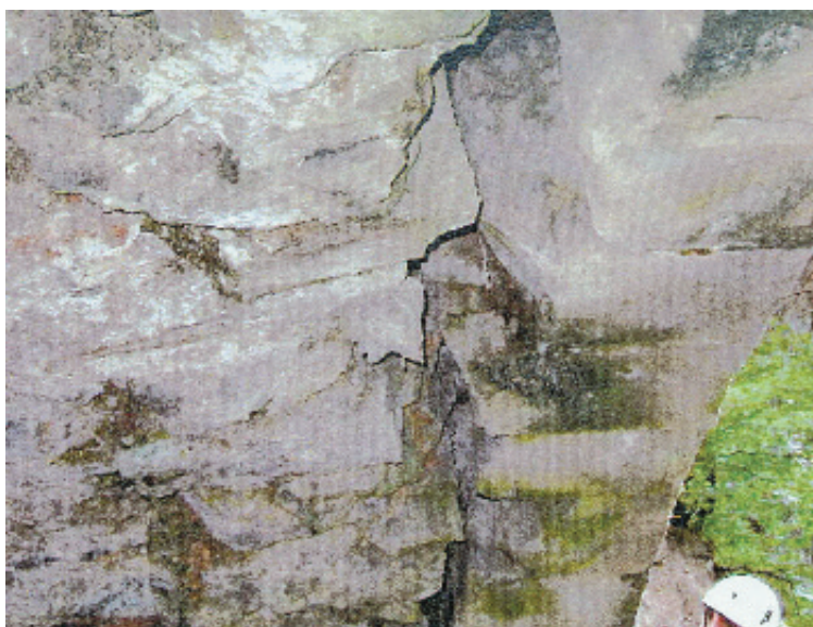
Photo n° 12 : maçonnerie en très mauvais état qui ne peut être considérée comme homogène (crédit photo DDE 74)
