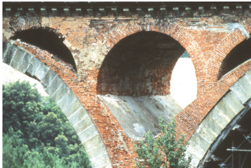
Photo n° 13 : exemple de désordres sur une voûte constituée de deux rouleaux (crédit photo CETE Méditerranée)
