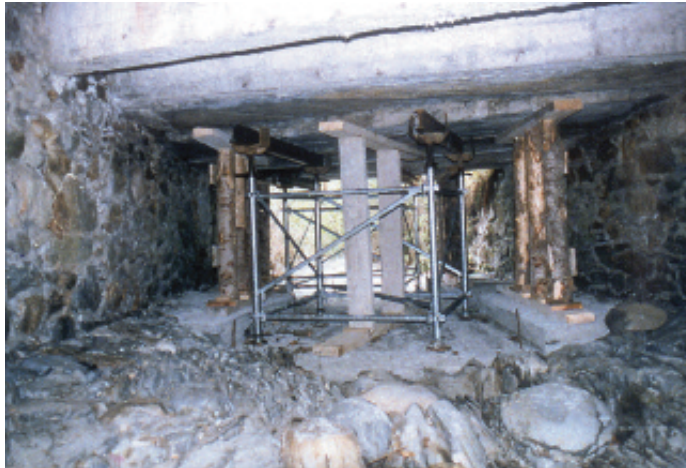
Photo n° 8 : étalement de sécurité d'un tablier en dalles de pierre fissuré (crédit photo DDE 65)
