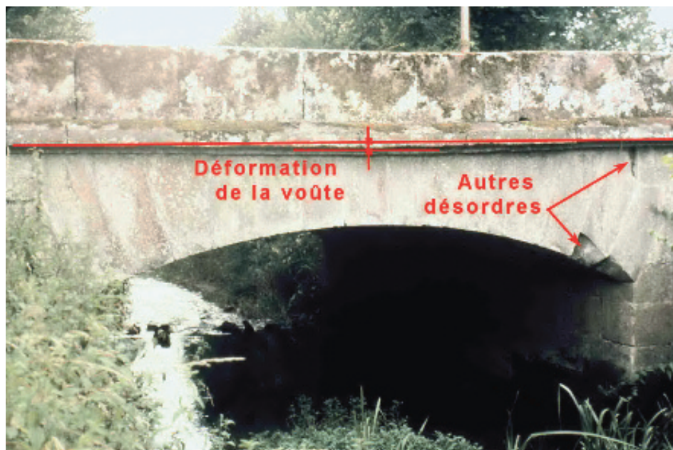
Photo n° 10 : désordres de la voûte très surbaissée du pont de Chapenois (crédit photo LRPC)
